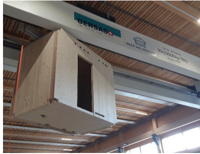
Abbildung 7: Badmodul am Hallenkran
